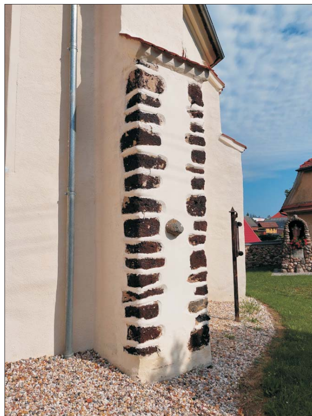
Ryc. 7. Kościół pw. św. Marcina w Świdnicy koło Zielonej Góry. Przypora ściany z wyeksponowanymi bloczkami rudy darniowej Fig. 7. St Martin's Church in Świdnica near Zielona Góra. Wall buttress with exposed bog ore blocks
