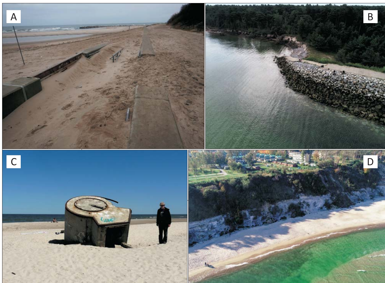
Ryc. 6. Przykłady interakcji ląd–morze i skutki ich oddziaływania na infrastrukturę: A – zasypane schody i przejście turystyczne; B – wzmożona erozja brzegu tuż za konstrukcją ochronną; C – uszkodzony fundament infrastruktury nawigacyjnej; D – osuwiska w bezpośredniej bliskości zabudowań. A i C – fot. G. Uściniowicz, B i D – fot. M. Olkowicz
