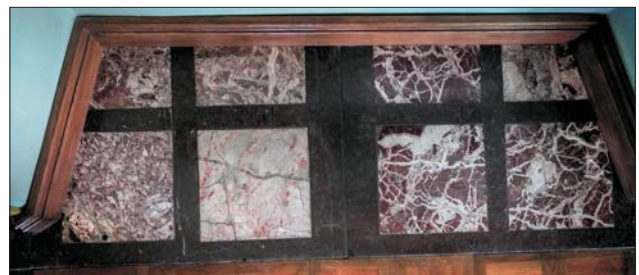
Ryc. 20. Pozostałości oryginalnej posadzki z wapienia bolechowickiego i różanki zelejowskiej we wnęce okiennej w trzecim pokoju biskupim Fig. 20. Remains of the original floor made of Bolechowice limestone and Zelejowa rosa-like calcite in the window recess in the third bishop's room
