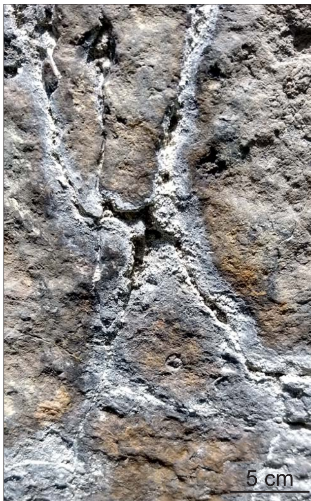
Ryc. 8. Fragment ściany wspinaczkowej. Widoczne przejawy wytrącania węglanów na powierzchni brekcji dolomitycznej. Fot. M. Rembiś
