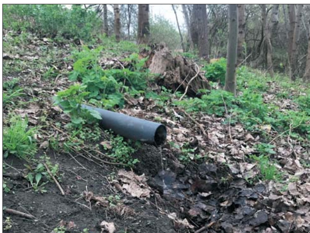
Ryc. 12. Nieodpowiednie odprowadzanie wód na teren ruchów masowych w miejscowości Rataje (nr 30-30-055-077332 w bazie SOPO) Fig. 12. Incorrect water drainage in the area of mass movements in the village of Rataje (No. 30-30-055-077332 in the SOPO database)
