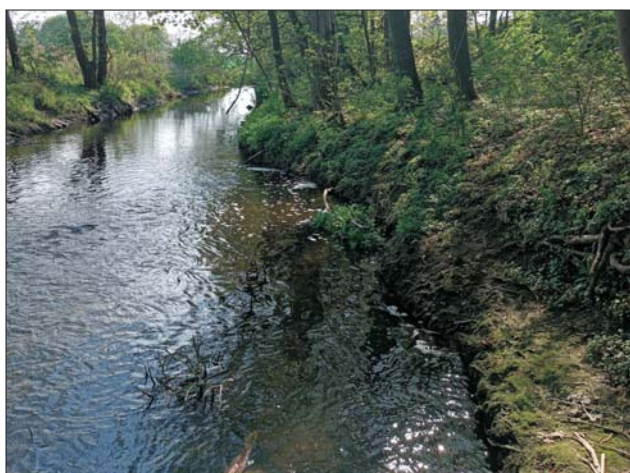
Ryc. 10. Podcinanie zbocza przez rzekę na terenie ruchów masowych w Gozdowie (nr 30-30-055-077347 w bazie SOPO)
