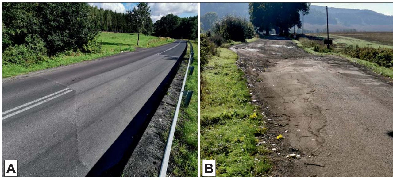
Ryc. 8. Przykłady dróg uszkodzonych w wyniku aktywności osuwisk w Sudetach: A – droga powiatowa (zbiorcza) nr 2491D na osuwisku nr 96411 w Siedlęcinie (powiat karkonoski, 2022 r.); B – droga powiatowa (zbiorcza) nr 2745D na osuwisku nr 96771 w Marciszowie (powiat kamiennogórski, 2022 r.)
