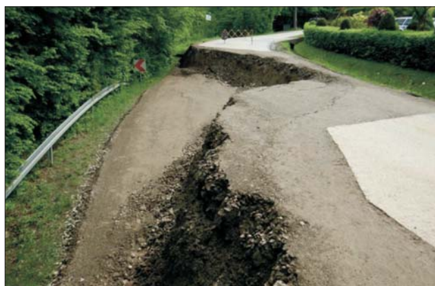
Ryc. 3. Osuwisko w Limanowej. Fot. A. Walicka
