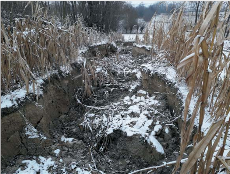
Ryc. 12. Zapadnięty kanał sufozyjny w Pławowicach. Fot. M. Wódka Fig. 12. Collapsed suffosion channel in Pawłowice. Photo by M. Wódka
