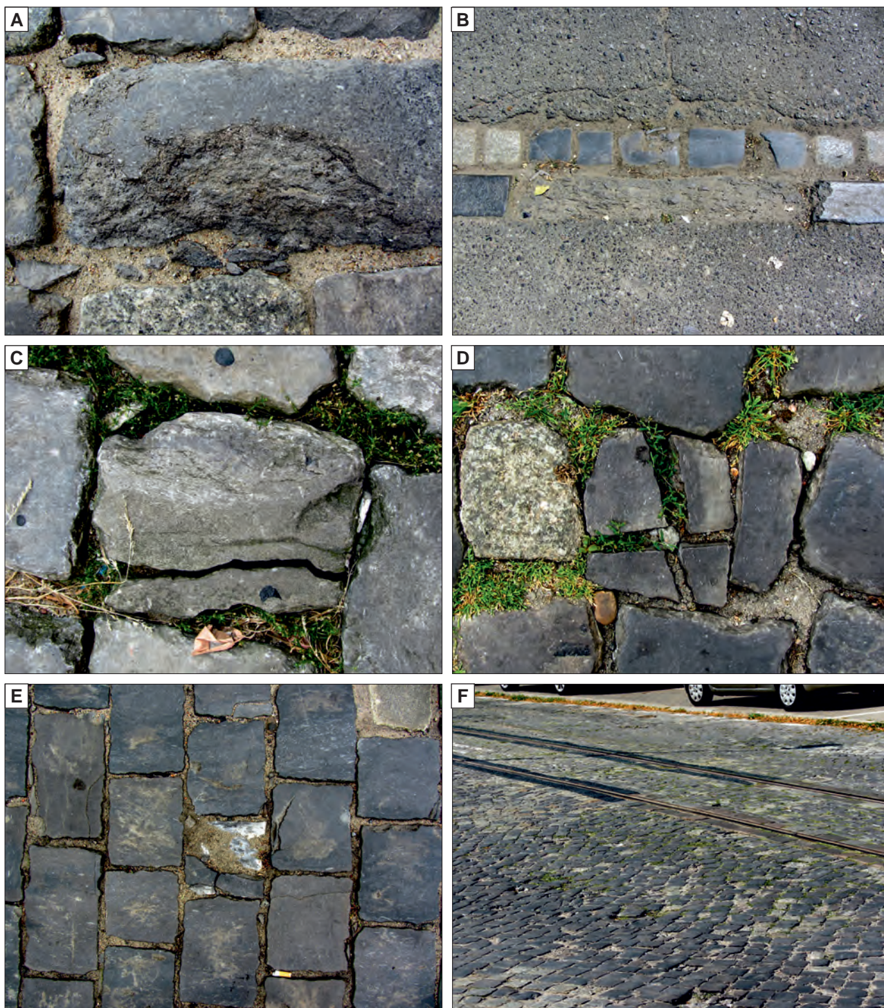
Ryc. 5. Przejawy degradacji nawierzchni wykonanych w Poznaniu z eocenu numulitowego: A – rozpadająca się kostka piaskowca o rozmiarach 35 × 20 cm, Stary Rynek; B – zniszczony krawężnik z piaskowca, sąsiadujący z nim element wykonany z mułowca jest dobrze zachowany, ul. 28 Czerwca 1956 r.; C – pęknięta kostka piaskowca, 12 × 9 cm, ul. Kozia; D – rozpadająca się kostka mułowca, 10 × 10 cm, ul. Zamkowa; E – odsłojenie na powierzchni kostki 15 × 15 cm, wzdłuż powierzchni żyły kalcytowej, ul. Romana Szymbalskiego; F – zdegradowana jezdnia ul. Emilii Szymbalskiej, z licznymi uzupełnieniami jasnym granitem strzegomskim
