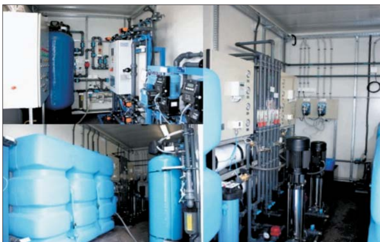
Ryc. 2. System odsalania wód termalnych w IGSMiE PAN Fig. 2. Thermal water treatment system in PAS MEERI
