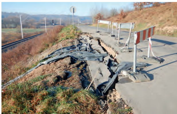
Ryc. 4. Osuwisko w Podolanach, gm. Kalwaria Zebrzydowska. Fot. S. Kamierniarz
