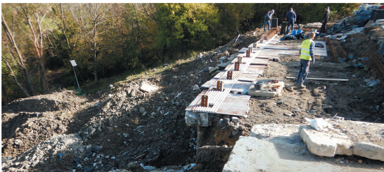
Ryc. 5. Zniszczenie parkingu w strefie skarpy głównej osuwiska w Bielsku-Białej. Fot. I. Laskowicz
