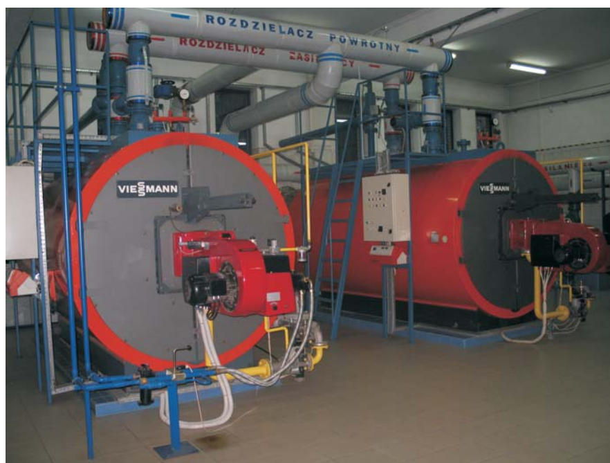
Ryc. 2. Ciepłownia gazowo-geotermalna w Mszczonowie. Fot. I.B. Litwin
