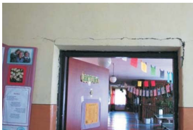
Ryc. 2. Pęknięta ściana w szkole w Starym Bystrem (Orawa). Pęknięcie powstało w wyniku trzęsienia ziemi w dniu 30 listopada 2004 r. Fot. M. Banaś
