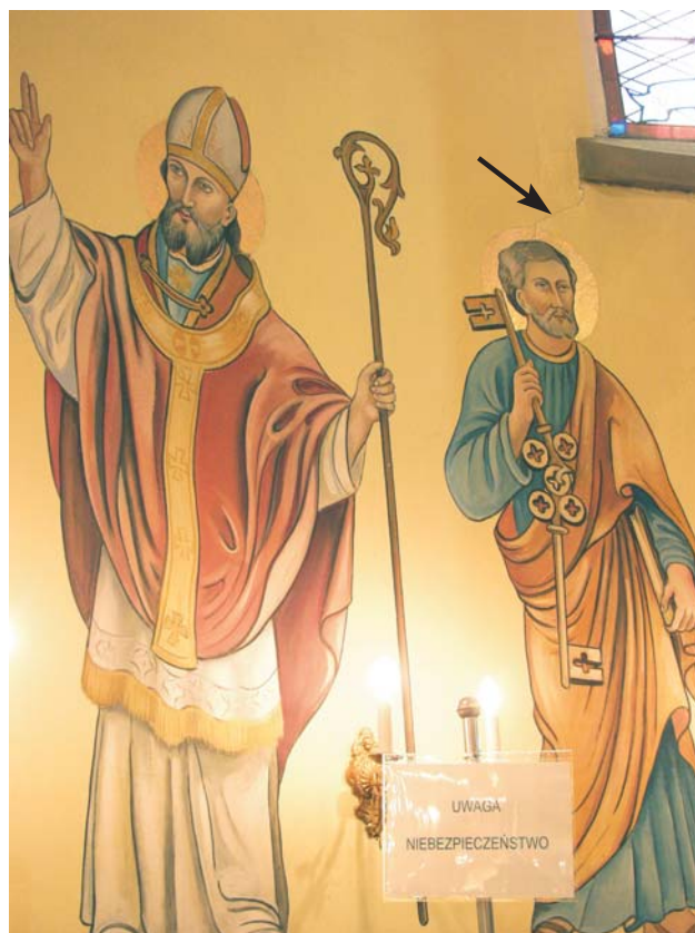
Ryc. 3. Pęknięte malowidło ściennie na ścianie kościoła w Miętusie (Orawa). Pęknięcie (zaznaczone strzałką) powstało w wyniku trzęsienia ziemi w dniu 30 listopada 2004 r. Fot. M. Banaś
