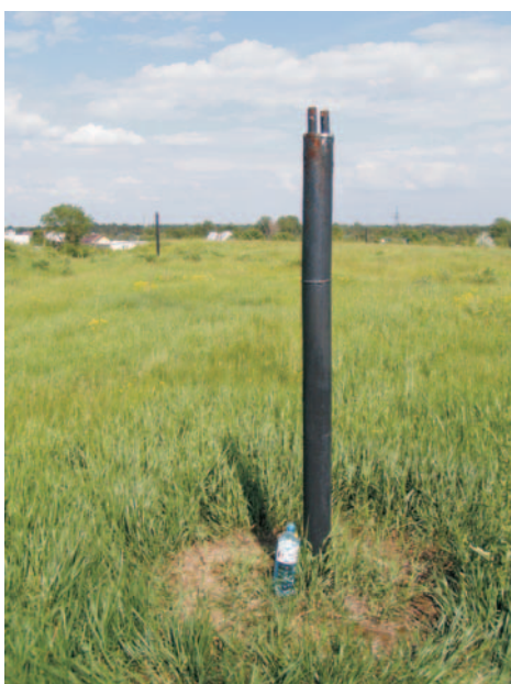
Ryc. 2. Otwór odgazowujący na składowisku Otwock. Fot. T. Gruszczyński
