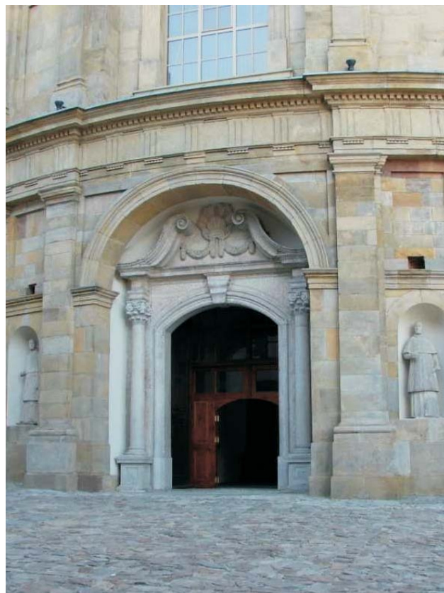
Ryc. 5. Piaskowiec kunowski w zachodniej fasadzie kościoła, rzeźby i portal wejściowy zdobi wapień dewoński
