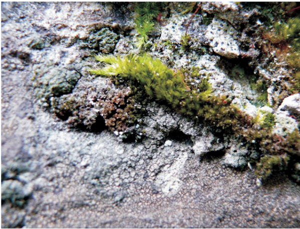
Ryc. 9. Mchy pokrywające powierzchnię piaskowca w bastionie północno-wschodnim. Fot. M. Korzeniowski
