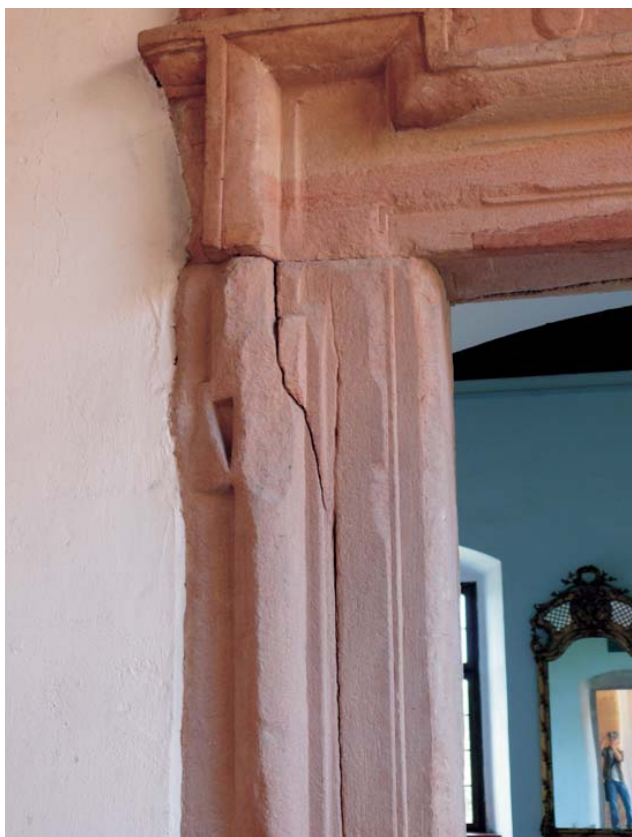
Ryc. 12. Portal wyrzeźbiony w piaskowcu istebniańskim. Zaawansowany proces destrukcji utrudnia odczytanie pierwotnej formy architektonicznej
