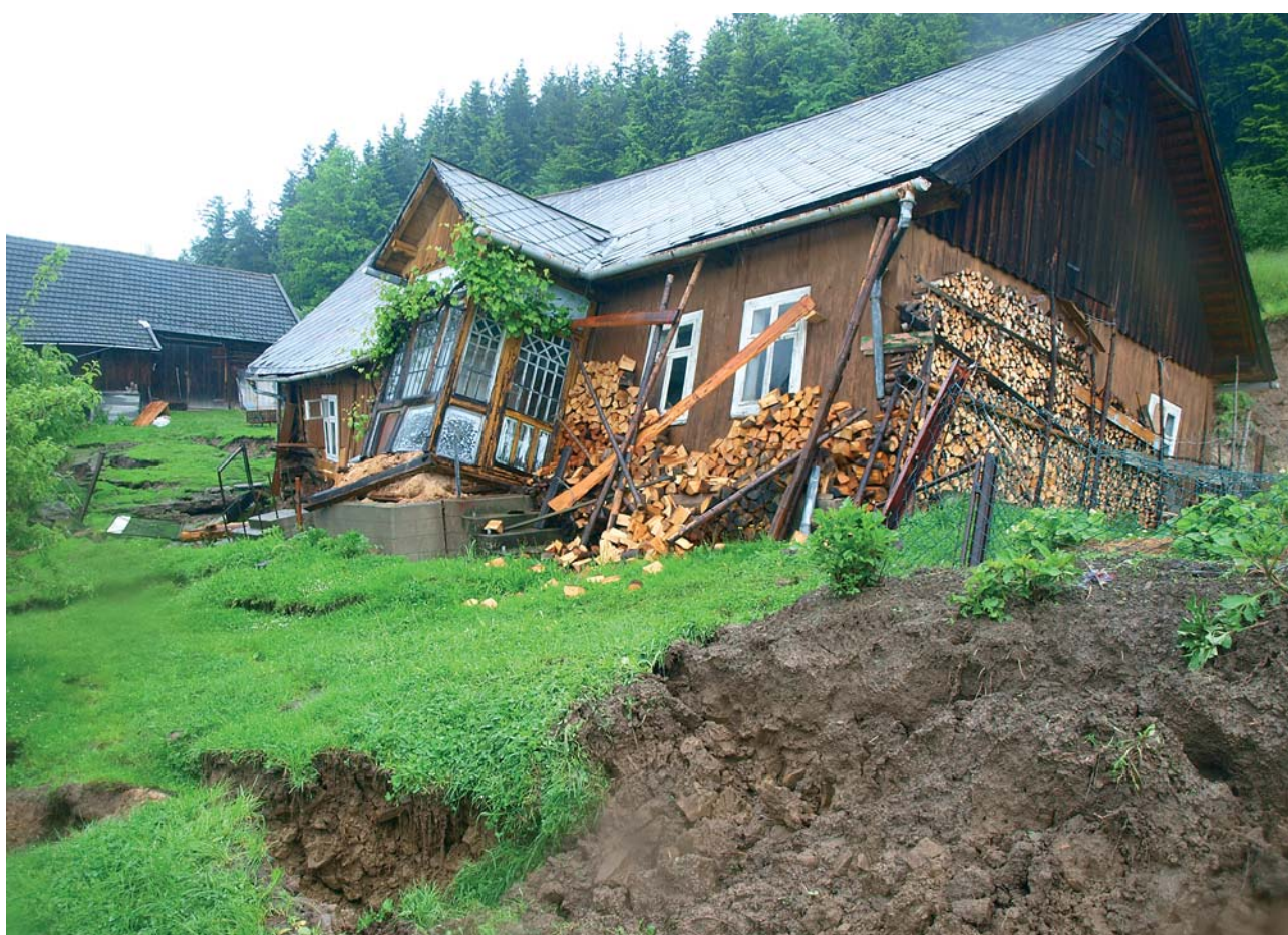
Ryc. 4. Zniszczony budynek w odnowionej części osuwiska, Kłodne k. Limanowej
