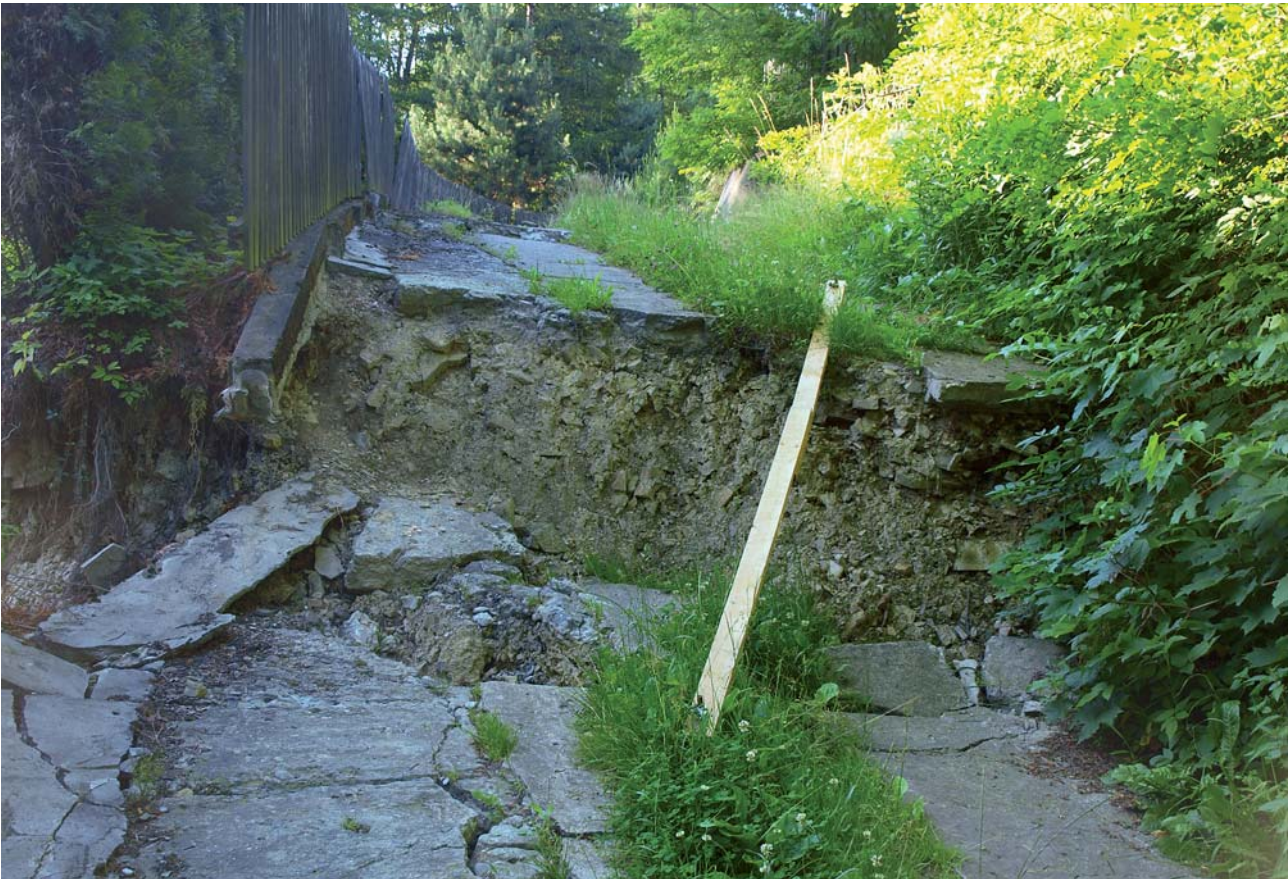
Ryc. 5. Droga zniszczona przez osuwisko, góra Żar, przysiółek Łaski (Międzybrodzie Bialskie)
