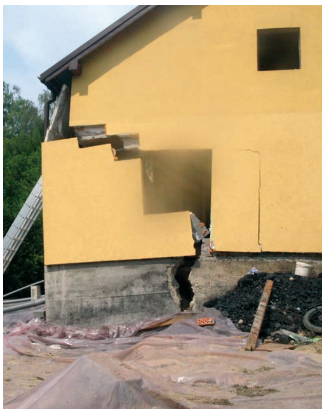
Ryc. 7. Fragment ściany domu zniszczonego przez ruchy osuwiskowe, Podchybie k. Lanckoronny
