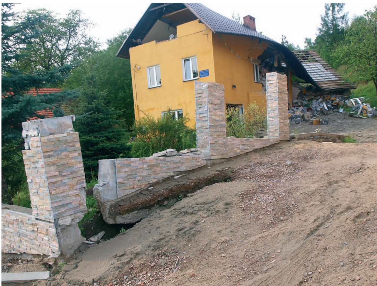
Ryc. 6. Dom zniszczony przez osuwisko, Podchybie k. Lanckoronny
