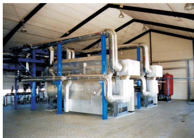
Ryc. 4. Widok na dwie absorpcyjne pompy ciepła. Fot. S. Kulik Fig. 4. View of two absorption heat pumps. Photo by S. Kulik
