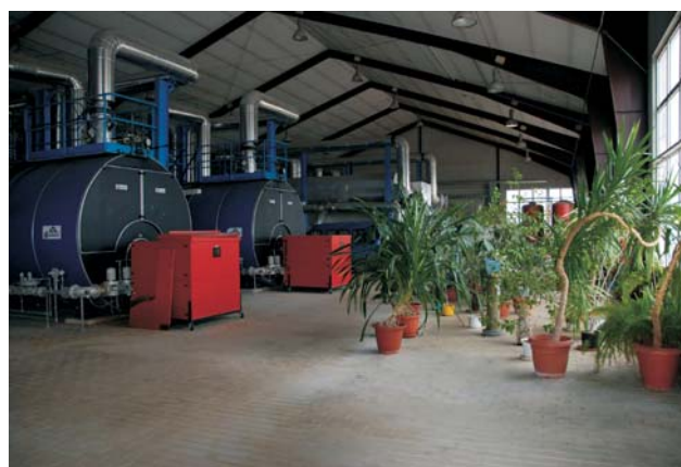
Ryc. 3. Hala ciepłowni geotermalnej w Pyrzycach. Fot. B. Noga Fig. 3. Hall of the Pyrzyce geothermal heating plant. Photo by B. Noga
