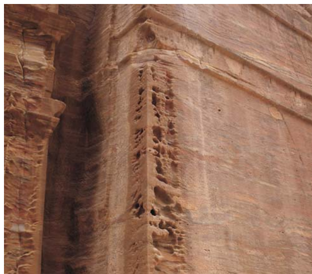
Ryc. 7. Grobowiec nr 67. Tafoni związane ze strefą zawilgocenia. Wszystkie fot. R. Buciak
