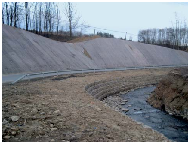
Ryc. 17. Osuwisko w Szymbarku po częściowej stabilizacji Fig. 17. Szymbark landslide after partial stabilization
