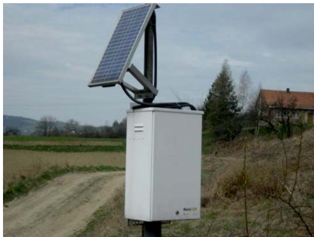
Ryc. 8. Stacja inklinometrów 3D, czujniki ciągłe, on-line Fig. 8. Continuous 3D inclinometer on-line station
