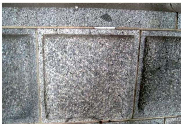
Ryc. 12. Zdziłowski „sjenit” o fakturze groszkowej w okładzinie filarów mostu ks. J. Poniatowskiego. Wszystkie fot. J. Wiszniewska
