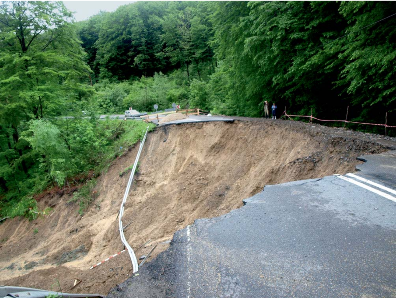
Ryc. 4. Widok na zniszczoną drogę wojewódzką w Kurowie w 2010 r. Fig. 4. View of the damaged provincial road at Kurów in 2010
