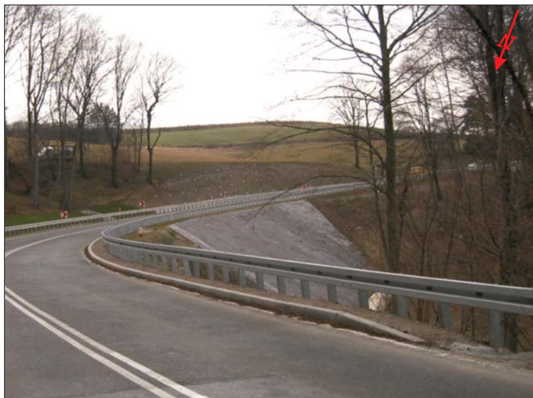
Ryc. 4. Zabezpieczenie południowej części osuwiska – rok 2017. Fot. J. Kos Fig. 4. Strengthened area of the southern part of landslide – 2017 year. Photo by J. Kos
