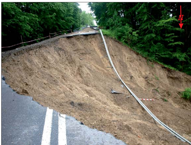
Ryc. 1. Skarpa główna osuwiska w Kurowie – maj 2010. Fot. A. Wójcik Fig. 1. Main scarp of landslide in Kurów – May 2010. Photo by A. Wójcik
