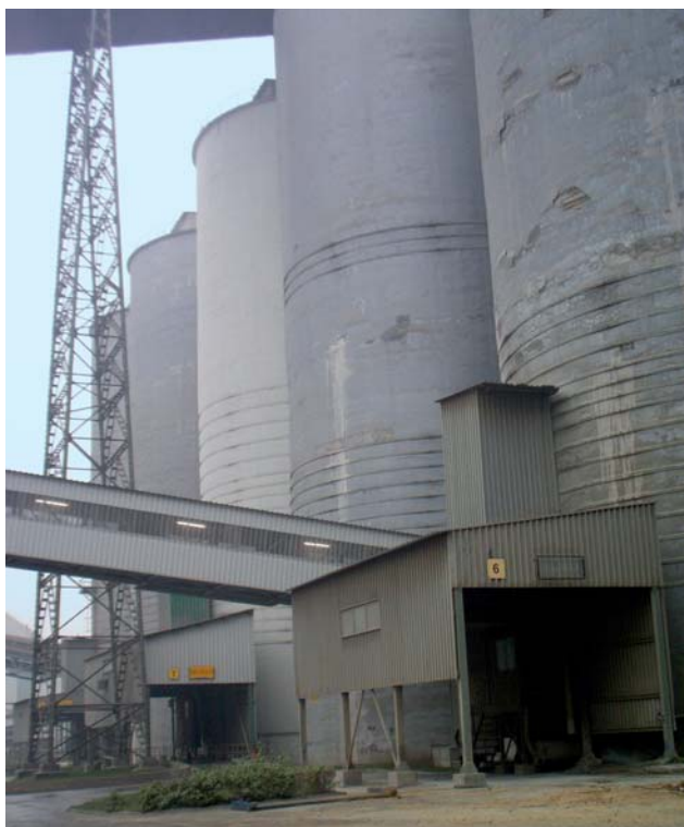
Ryc. 1. Uszkodzenia płaszczy silosów na cement. Fot. S. Kwiecień Fig. 1. Damaged silos walls. Photo by S. Kwiecień
