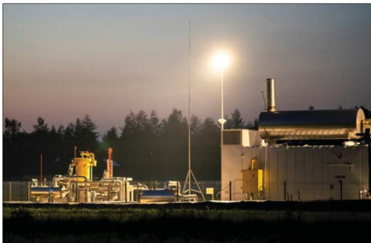
Ryc. 6. Instalacja do produkcji energii elektrycznej w Gilowicach. Fot. Arch. PGNiG S.A.
