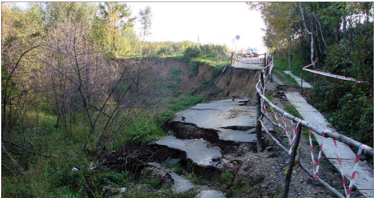
Aktywne osuwisko niszczące drogę gminną w miejscowości Grabno (gmina Wojnicz, powiat tarnowski). Fot. P. Marciniac An active landslide damaging the municipal road in Grabno (Wojnicz commune, tarnowski county). Photo by P. Marciniac
