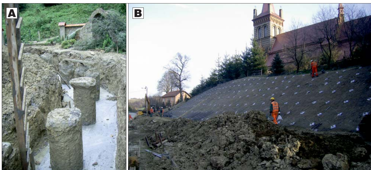
Ryc. 4. Stabilizacja osuwiska z zabezpieczeniem kościoła w Niewodnej: A – pale na stoku powyżej kościoła (foto A. Wójcik), B – pale na stoku poniżej kościoła. Fot. A. Hojdak
