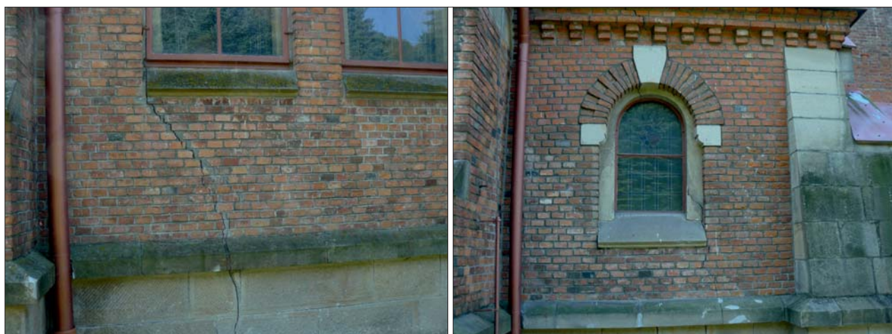
Ryc. 3. Uszkodzenia ścian kościoła w Niewodnej Fig. 3. Damage of the church walls in Niewodna
