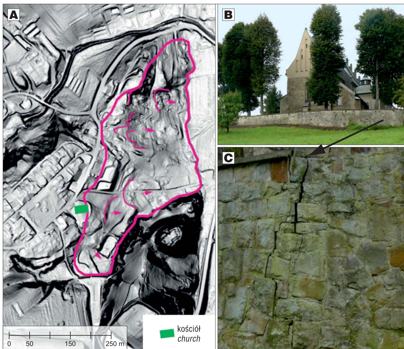
Ryc. 1. Kościół na osuwisku w Czchowie: A – osuwisko, B – widok ogólny zabytkowego kościoła, C – szczeliny w ogrodzeniu Fig. 1. Church on the landslide in Czchów: A – landslide, B – general view of the heritage church, C – cracks in the fence wall
