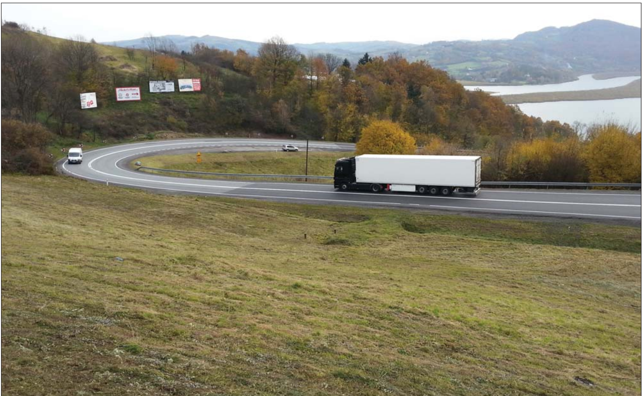
Osuwisko Just. Fragment drogi krajowej DK75 niszczonej przez ruch osuwiska. Fot. Z. Perski, 06.11.2014 r.
