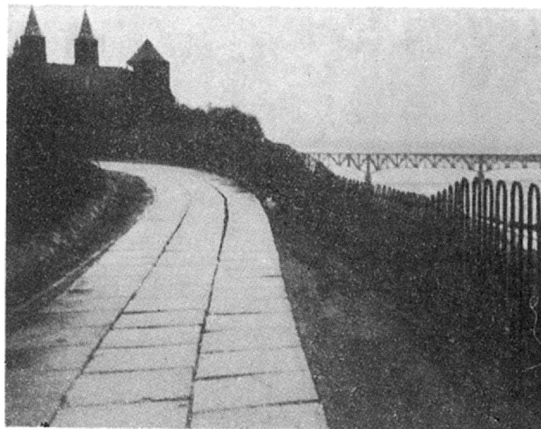
Ryc. 1. Deformacje przygotowujące osuwisko, skarpa pod Domem Turysty wiosną 1967 r.
