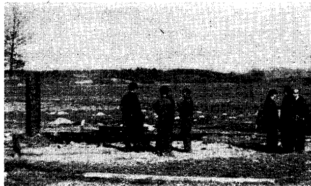
Ryc. 4. Widok ogólny zainstalowanego piezometru z zabezpieczeniem.
