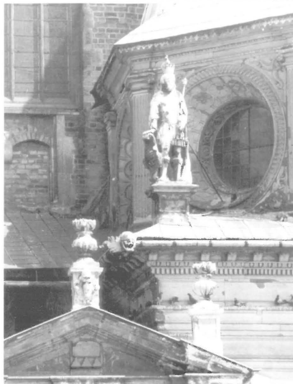
Ryc. 5. Intensywna dezintegracja wapienia pińczowskiego (rzeźba św. Zygmunta w narożniku Kaplicy Wazów w Katedrze na Wawelu), powodująca zanik detali rzeźbionych
