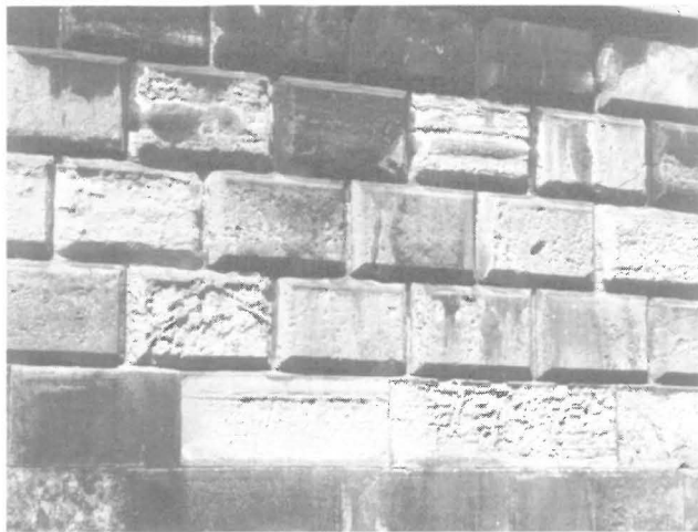
Ryc. 3. Zróżnicowanie efektów deterioracji dolomitu libiąskiego. Widoczne bloki z licznymi kawernami, intensywną eksfoliacją powierzchni, drobnymi wżerami oraz bloki nieznacznie uszkodzone. Mur wokół Katedry na Wawelu
