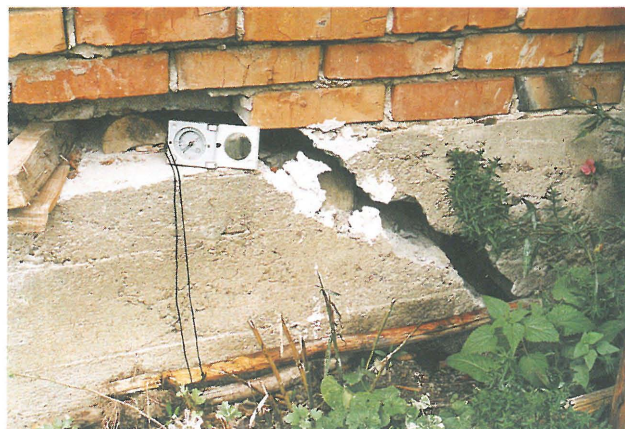
Ryc. 4. Uszkodzony fundament jednego z budynków mieszkalnych w przysiółku Jamrozówka; fot. 3–4 L. Bober
