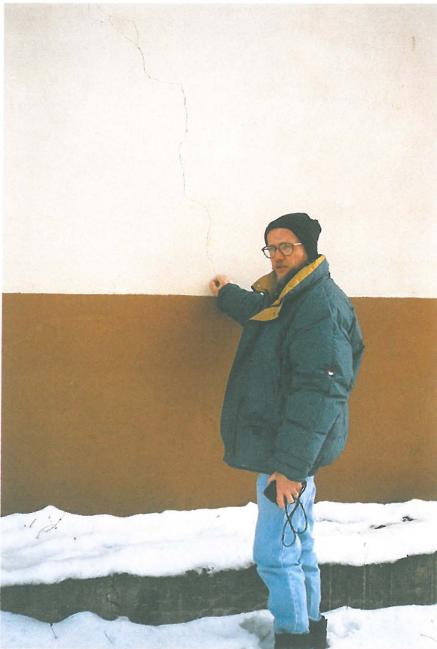
Ryc. 2. Pęknięcie ściany budynku w Podczerwonym utworzone podczas wstrząsów sejsmicznych w 1995 roku Fig. 2. Fracture formed during the 1995 earthquake in a building in Podczerwone
