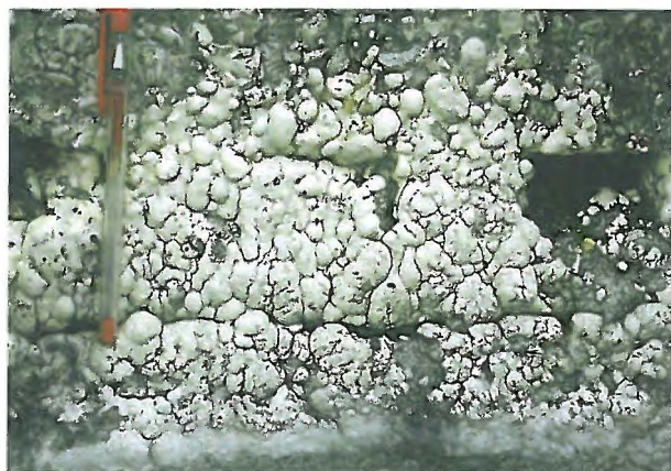
Ryc. 4. Biały osad oskorupiający betonowe ściany rowu w strefie rozprysku wody wypływającej ze źródła „Główne” w Swoszowicach Fig. 4. White crustifications on concrete walls of the trench within the splash zone of the water flowing out off the „Główne” spring in Swoszowice
