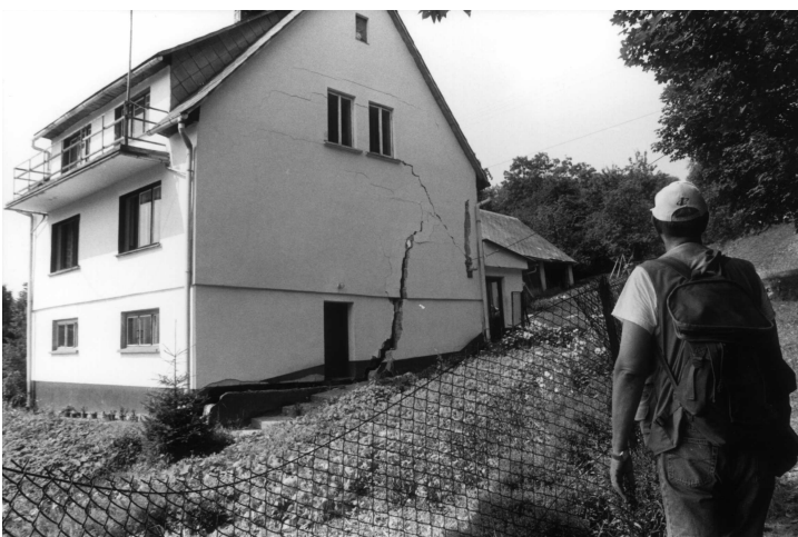
Ryc. 10. Otwarte szczeliny w nowym budynku przy wschodniej, bocznej krawędzi starego osuwiska Fig. 10. Open fissures in a new building near the eastern, marginal side of the old landslide
