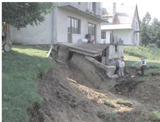
Ryc. 7. Nisza osuwiska podcinającego fundamenty zabudowań mieszkalnych w Muszynie na zboczach opadających w stronę doliny Popradu (lipiec 2002)
