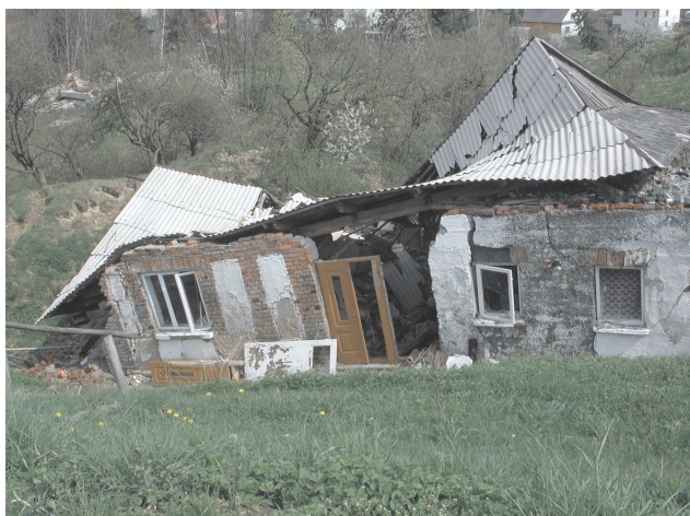
Ryc. 8. Budynek mieszkalny zniszczony przez osuwisko w Lachowicach. Budynek ten zjechał wraz z kolumiami osuwiskowymi około 20 m w dół stoku
