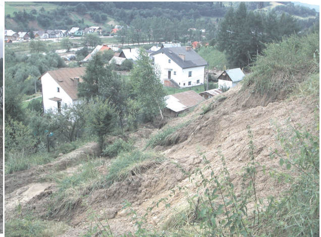
Ryc. 2. Zniszczenia powstałe w obrębie zboczy doliny Muszynki (lipiec 2002) Fig. 2. Deteriorations formed on the valley sides of the Muszynka stream (July 2002)
