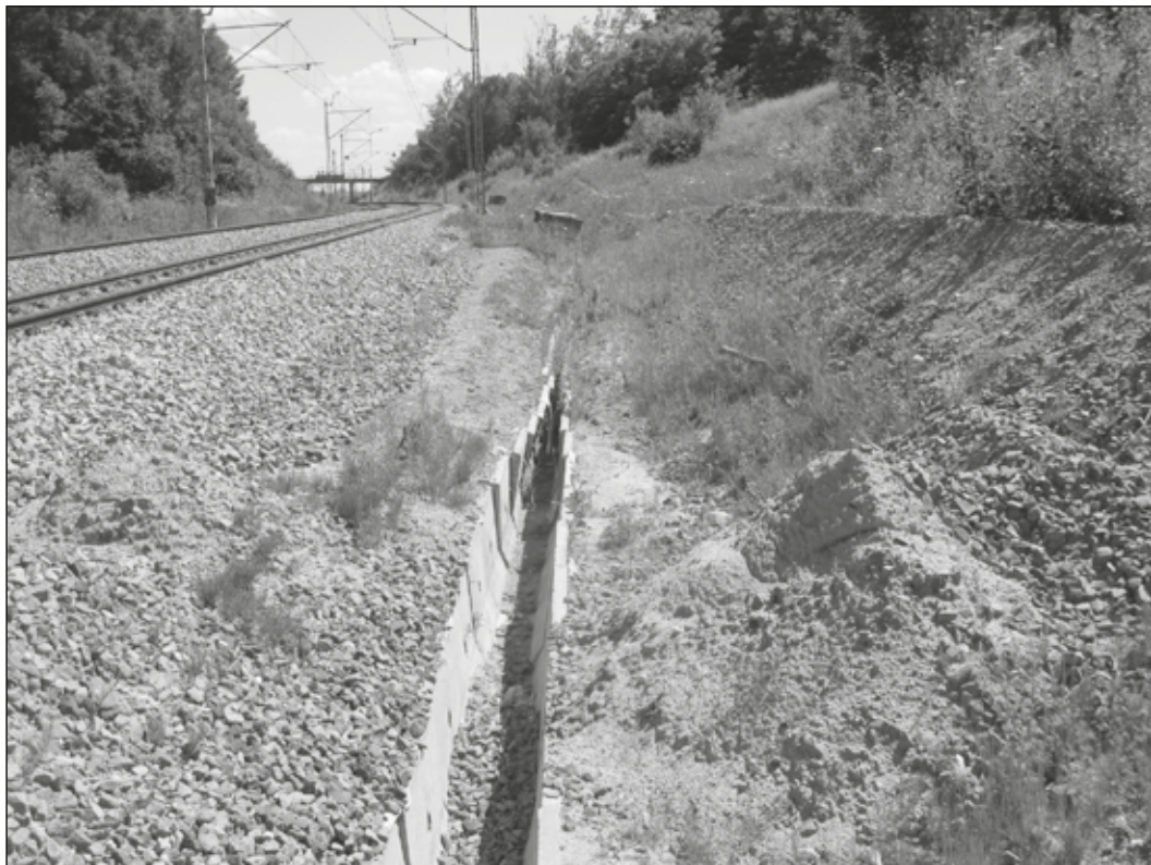
Fig. 22. Zaciśnięta korytka i uszkodzone tory kolejowe – osuwisko Sadowie
