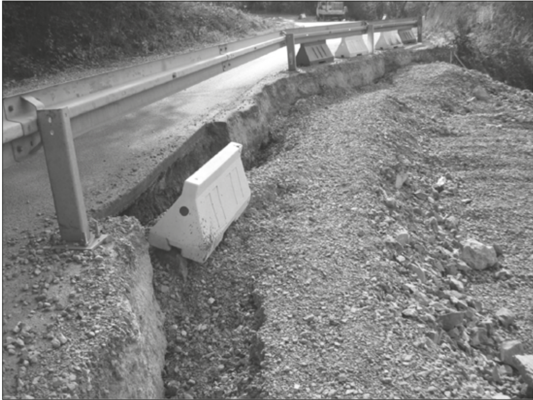
Fig. 14. Uszkodzona droga powiatowa na osuwisku w Ochojnie
