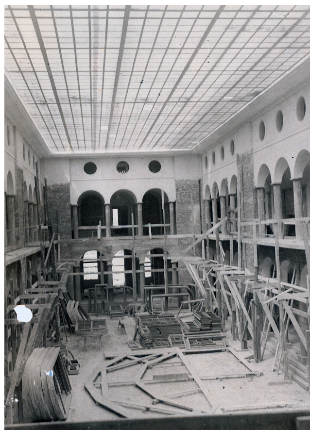
Fig. 3. Prace budowlane we wnętrzu głównego gmachu PIG – lata 1928–1934 (Narodowe Archiwum Geologiczne PIG-PIB)
