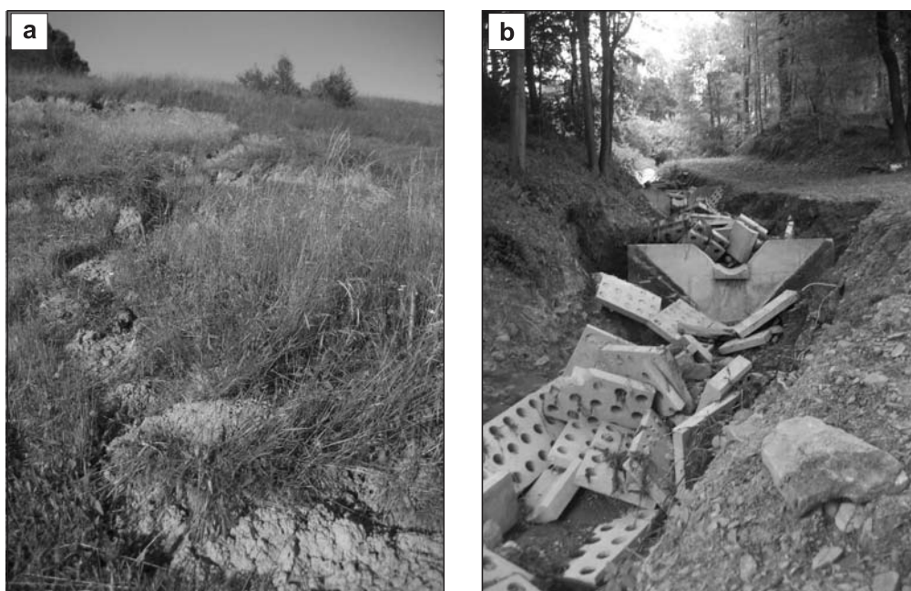
Fig. 3. Osuwisko nr 5 (maj 2010): a – zerwy osuwiskowe, b – zniszczone rowy odwadniające Landslide no. 5 (May 2010): a – new cracks, b – damaged drainage system
