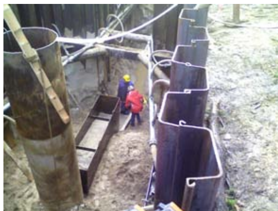
Fig. 2. Układanie drenażu – widoczna studnia zbiorcza, skrzynka z obsypką drenażu i system odwodnień igłofiltrami (fot. J. Cichočka, 2010 r.)
